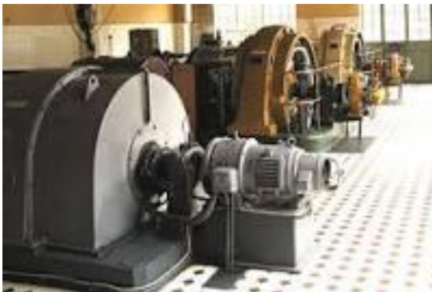
Фиг. 5.2. Общ изглед на машинна зала на ВЕЦ „Енина”.
